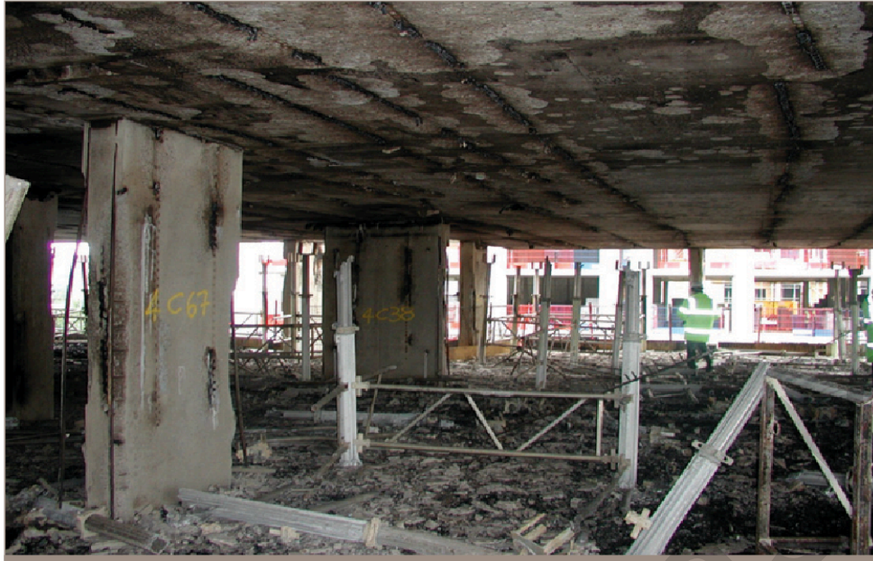
Figura 4.10. Veduta dell'interno della struttura in cemento danneggiata dall'incendio.
